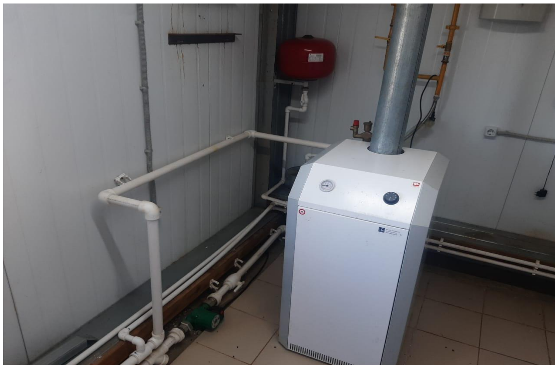
Рисунок 6. Газовый котел, насос, расширительный бак
