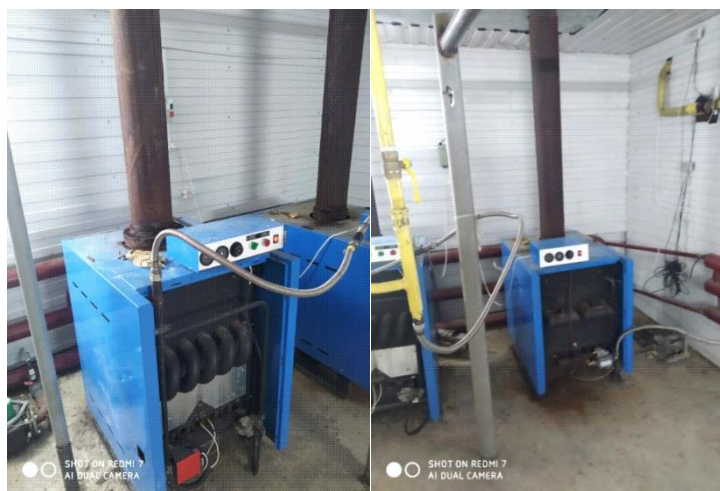
Рисунок 4. Два газовых напольных котла
